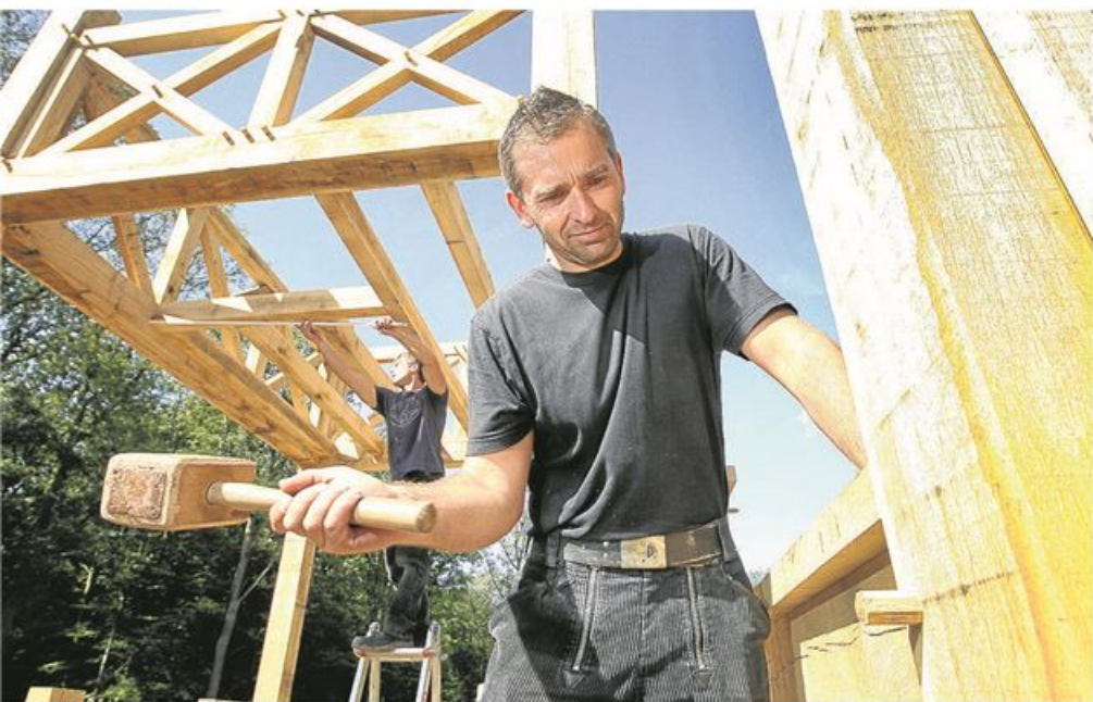
Das Nordtor soll – wie schon zuvor die Holz-Erde-Mauer – nach überlieferten Handwerkstechniken gebaut werden. FOTO: ARCHIV/MILK
